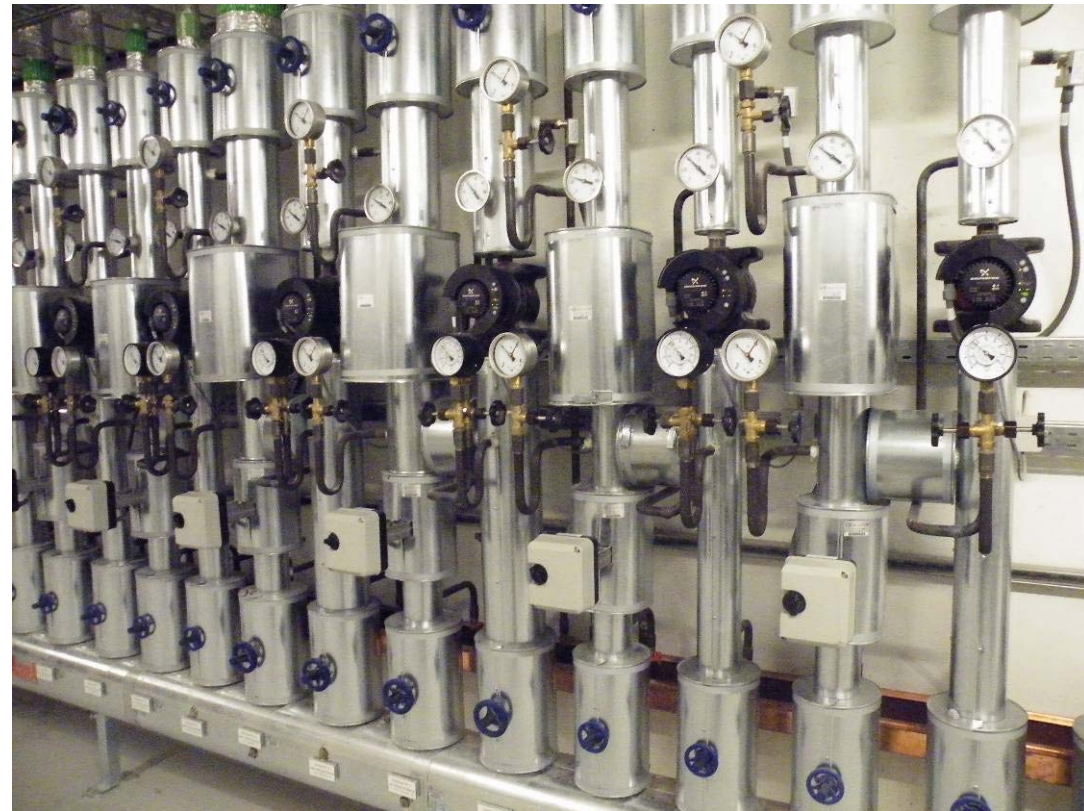
Neue Umwälzpumpen mit Beimischregelung
